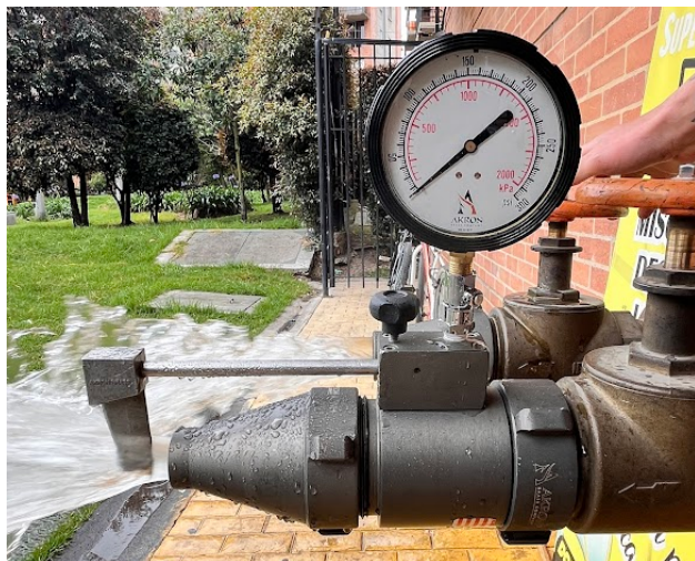
Prueba de rendimiento de la bomba contra incendios
